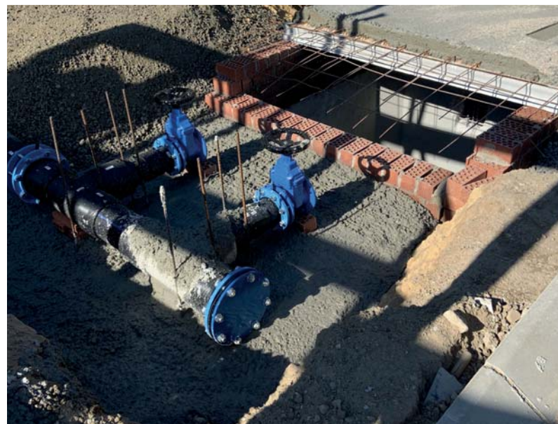
Tanque de Tormentas, Sevilla.
