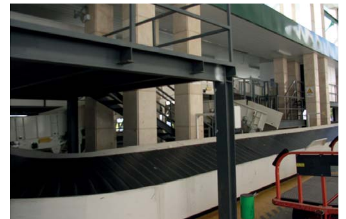
Instalación de sistema de equipajes del Aeropuerto de Jerez de la Frontera (Cádiz).
